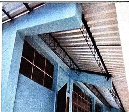
Foto 2: La estructura metálica de la base de lámina se había pintado con color negro.
